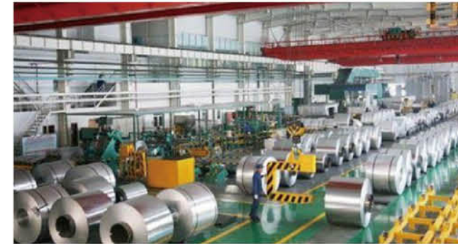
项目名称: 山东炉业项目 安装容量: 2200kVar+4500A 所属行业: 冶金铸造 治理对象: 电解设备
