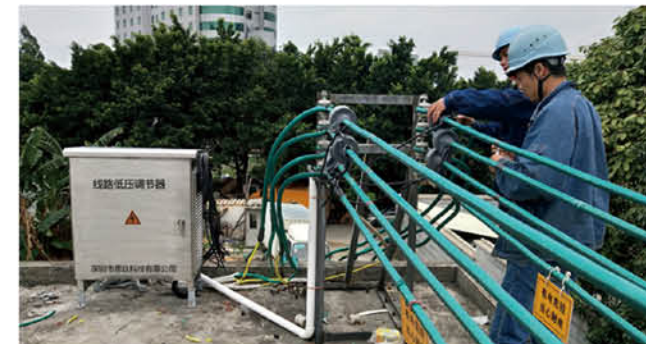
项目名称: 南方电网河源供电局项目 安装容量: 30KVA 所属行业: 南方电网 治理对象: 低电压末端线路
