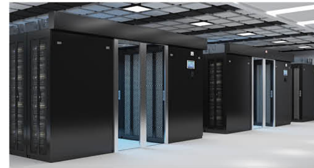
项目名称: 北京电信数据中心项目 所属行业: 通讯 安装容量: 3600A 治理对象: UPS、变频器
