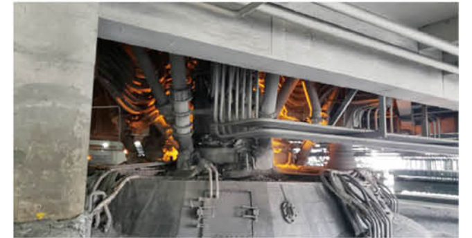
项目名称: 四川甘孜电石炉项目 安装容量: 3600kVar 所属行业: 冶金铸造 治理对象: 中频炉
