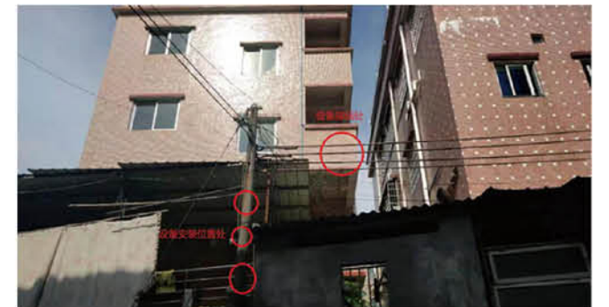
项目名称: 浙江衢州供电局项目 安装容量: 30KVA 所属行业: 国家电网 治理对象: 低电压末端线路
