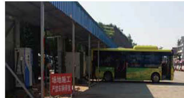
项目名称: 深圳南山公交充电站 安装容量: 400A 所属行业: 新能源、交通 治理对象: 充电机
